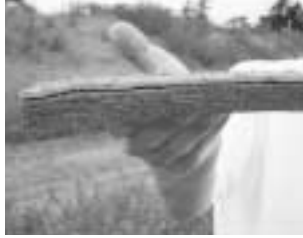
図10 層状になっているひび 割れ
